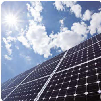
Generering av solcellsenergi hos EVVA
